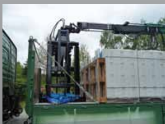
Ablageposition der Steinzange hinter Stirnwand
